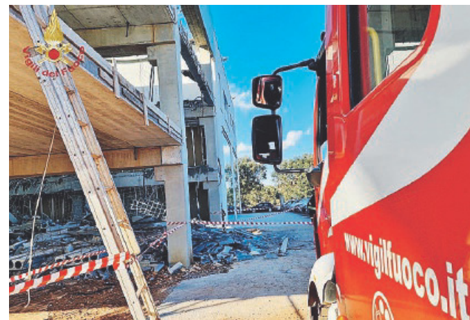
S. MICHELE Il cantiere dove è morto Franco Mastrovito
